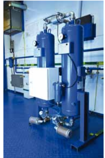
KSI ATK mit pneumatischer Steuerung in einer Containeranlage in Chelyabinsk.
